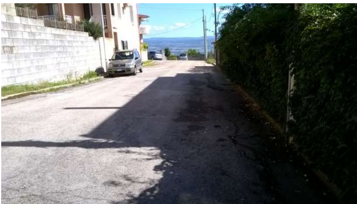
Via Wagner - zona tratto di marciapiede da ripristinare
